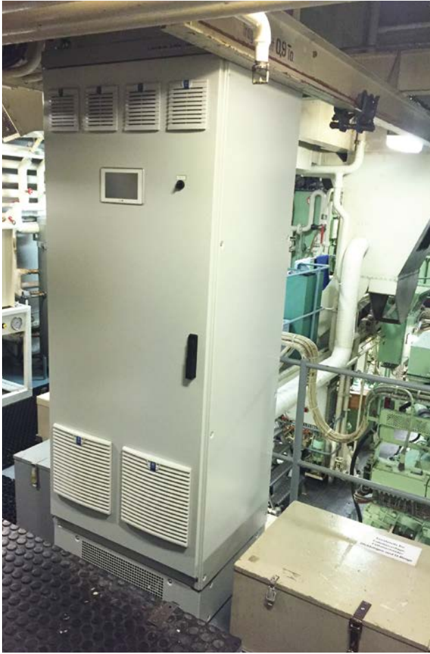
Filtro activo instalado en la sala de máquinas
